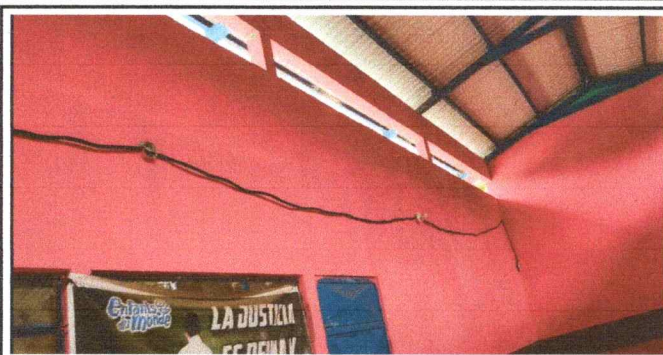
Foto 2: MANTENIMIENTO DE SISTEMA ELECTRICO
